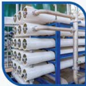
Effluent Treatment Plant (ETP)
